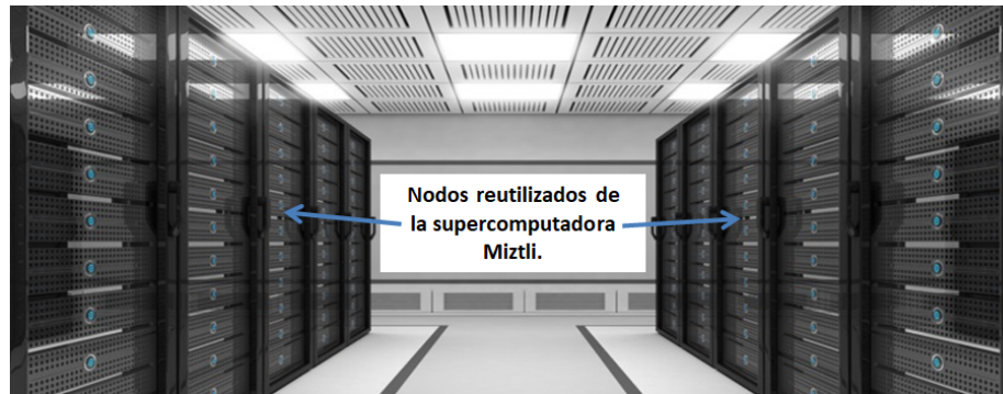
Fig. 14, Centro de Datos de DGTIC reacondicionado.
